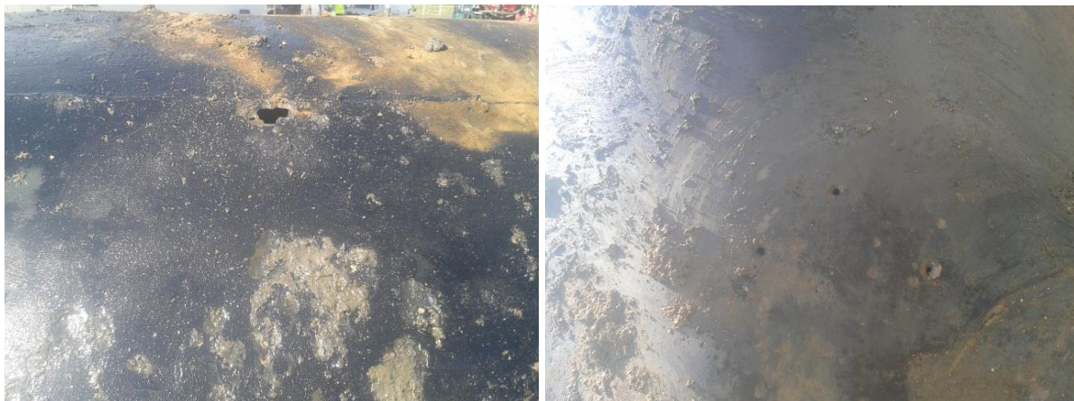
Figure 7: Vues sur les trous observés dans la troisième cuve (non inertés au béton).
