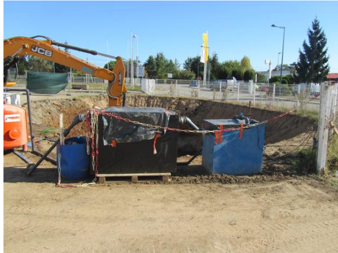
Figure 14 : Vue unité de traitement des eaux
