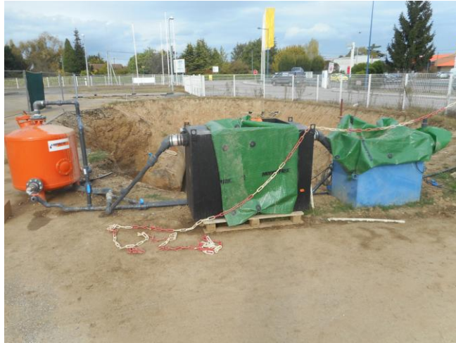
Figure 15 : Vue unité de traitement avec système de recirculation des eaux
