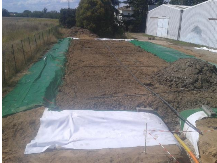
Figure 10: Vue sur le biotitre et le premier réseau d'extraction
